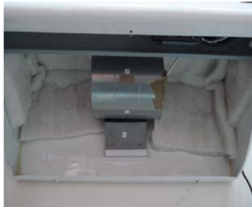
改善後(排油煙機內部圖)
